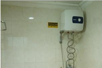
Water Heater di Kamar Asrama
